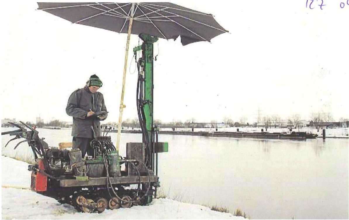
Derzeit werden am Schwabelweiser Donauufer Probebohrungen für den Hochwasserschutz durchgeführt. Foto: hs
