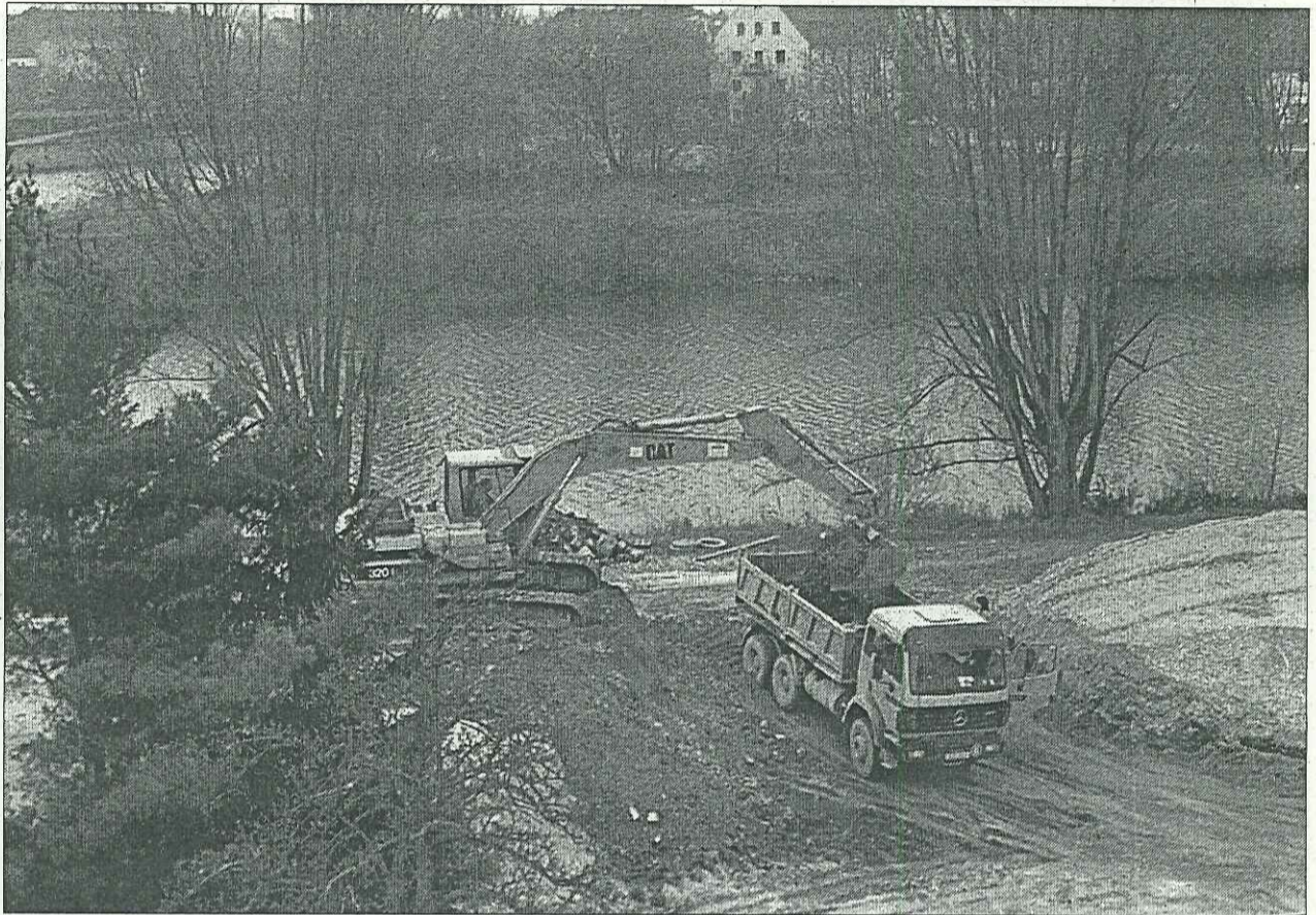
Zweiter Versuch: Die Bagger reißen den neuen Damm südlich der Frankenbrücke wieder ein und bauen ihn neu. Die Dichtigkeit entsprach nicht der Norm. Fotos: Stöcker
