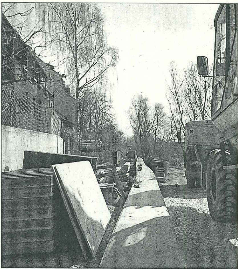
Die Spundwand ist im Boden verschwunden, zu sehen ist nur noch der Kopfbalken aus Beton mit einer Ankerplatte aus Stahl (Mitte) für den beweglichen Hochwasserschutz. Links, wo jetzt noch Baumaterial lagert, entsteht in den nächsten Wochen eine begehbare Rasenfläche, die auch zum Antransport des Dammbalkensystems gedacht ist. Rechts in Richtung Donau wird das Gelände abgebösch. Der Uferweg an der Donau bleibt erhalten. Fotos: Stöcker
