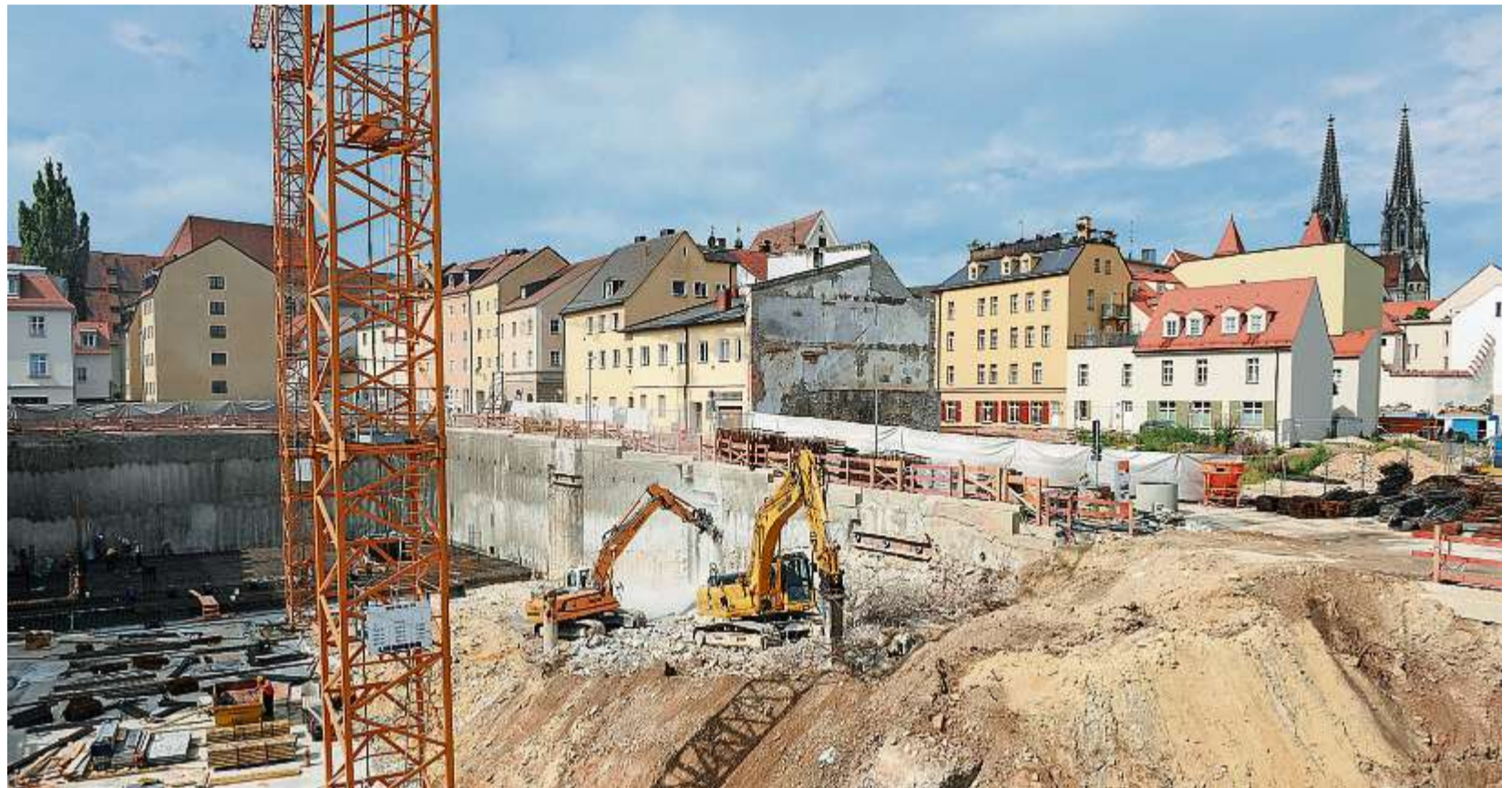
Am Donaumarkt laufen die Vorarbeiten für das Bayernmuseum. Die Stadt muss dafür zwölf Millionen investieren. Fotos: Lex (1), Wiedemann (1), Gruber (3)
