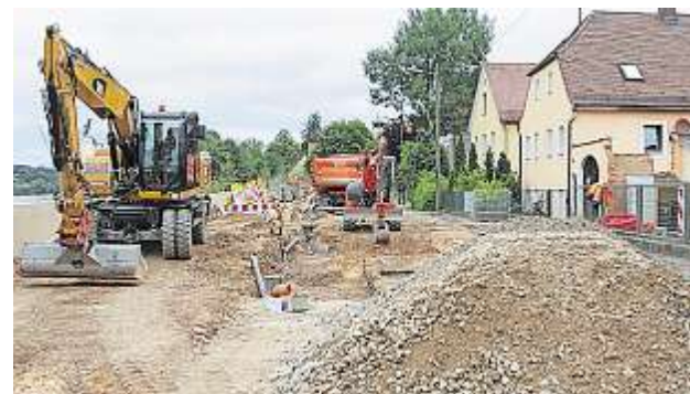
In der Oberen Regenstraße muss noch viel getan werden.
