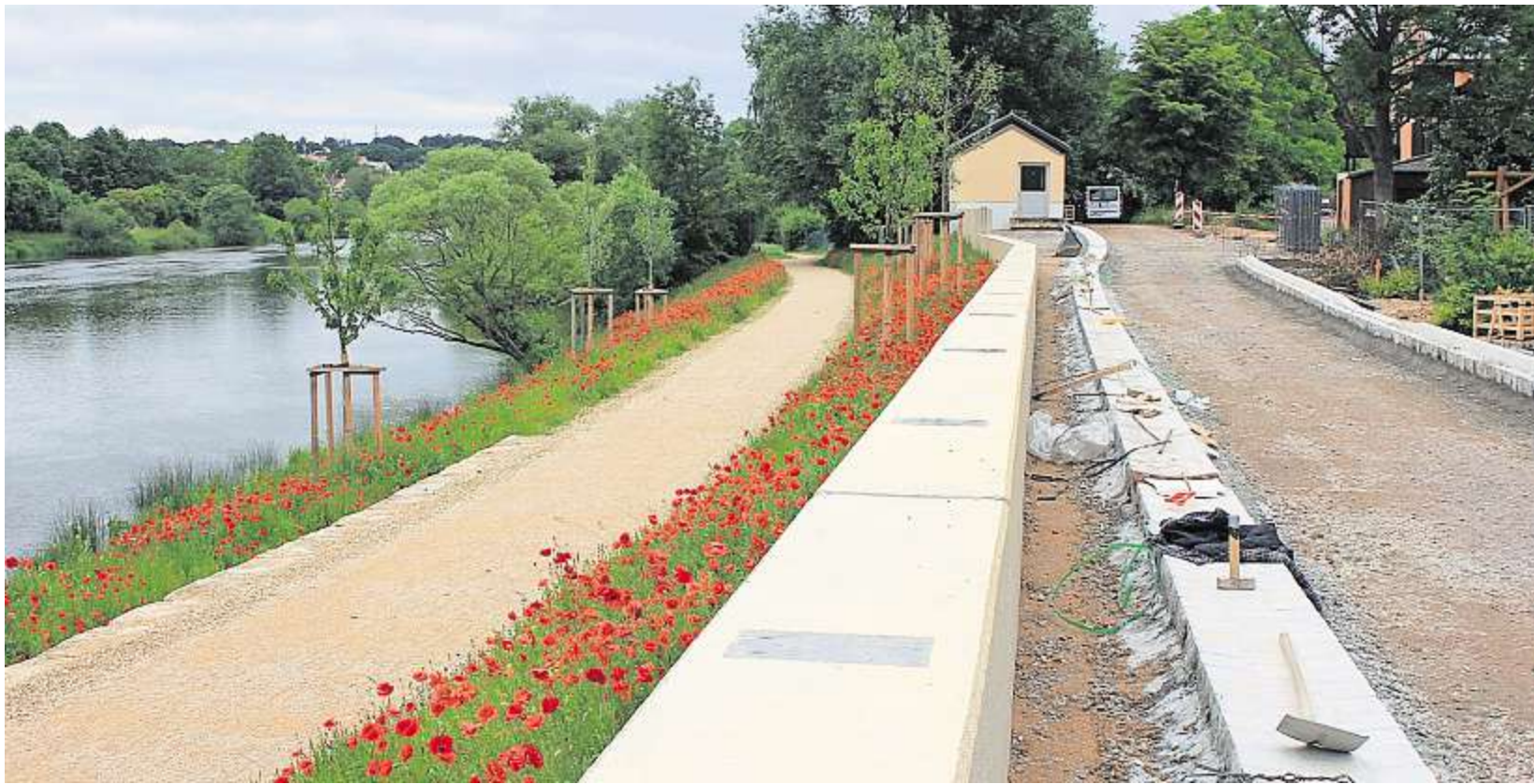
Zwei Welten entlang einer Hochschutzmauer in Reinhausen: Während es am Fuß- und Radweg des Regens grünt und blüht, sind an der gegenüberliegenden Seite die Bauarbeiten im Bereich der Uferstraße (rechts im Bild) und der Oberen Regenstraße noch voll im Gange. Fotos: Daniel Steffen
