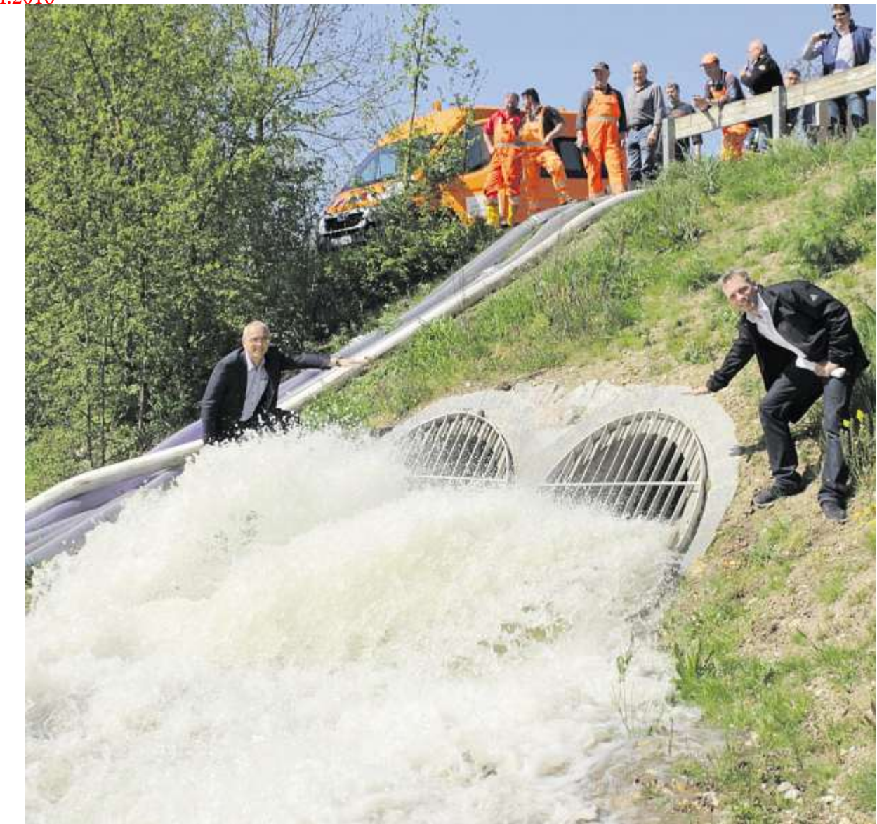
Ein Riesenschwall Wasser schießt aus den Rohren: Franz Kastenmeier (l.) und Rainer Zimmermann demonstrierten die Arbeitsweise des neuen Pumpwerks Reinhausen nahe der Nibelungenbrücke.
