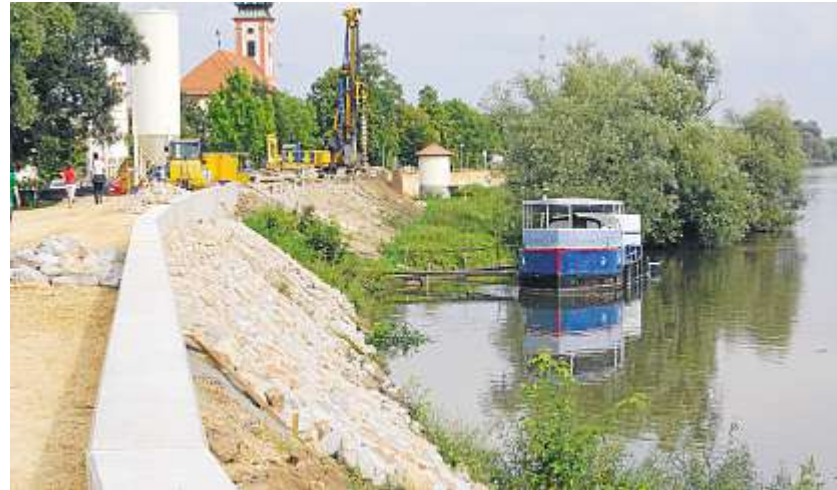
Nur wenige Tage nach Beginn der Bauarbeiten war der Fortschritt der Hochwasserschutzmaßnahme schon gut erkennbar. Foto: Scherrer
