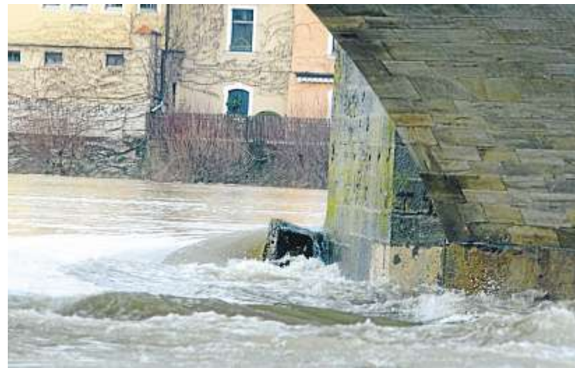
Die Brückenpfeiler sind umflutet, die Pegel steigen. Foto: Lex
