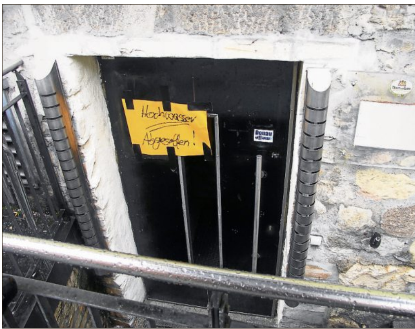
„Abgesoffen!“, meldete bereits am Samstagabend die Wunderbar in der Keplerstraße. Die beliebte Cocktailkneipe wird derzeit leergepumpt, so gut das bei weiter ansteigendem Grundwasserpegel eben geht.
