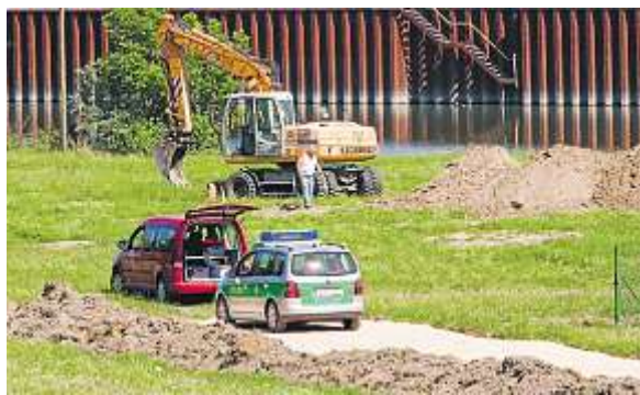
Auf dem sogenannten Donauspitz in der Nähe des Ölhafens wurden die Bomben gefunden.
